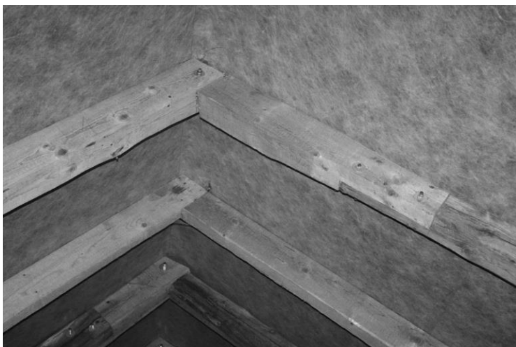
Nové protězy tvořící uhnílý hřeben střechy napojené na staré krovy přeplátováním a stažené ocelovými svorníky.
