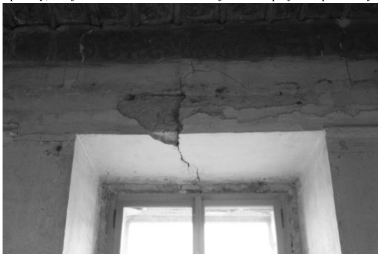
Neškodná trhлина v okenním ostění způsobená přirozeným sedáním základu pravděpodobně někdy v období po bezprostředním dokončení stavby
