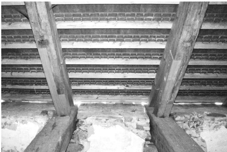
Dolní část krokvi je nastavená novými protězami
