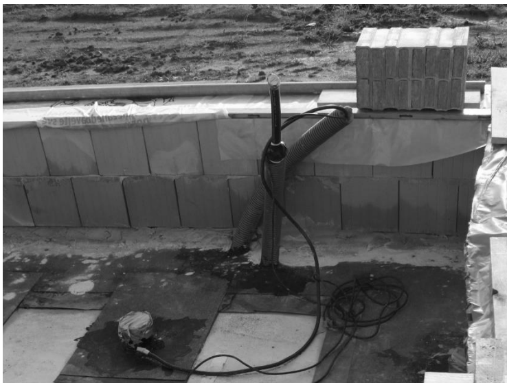
Přípojka elektra prostupující základovou deskou
